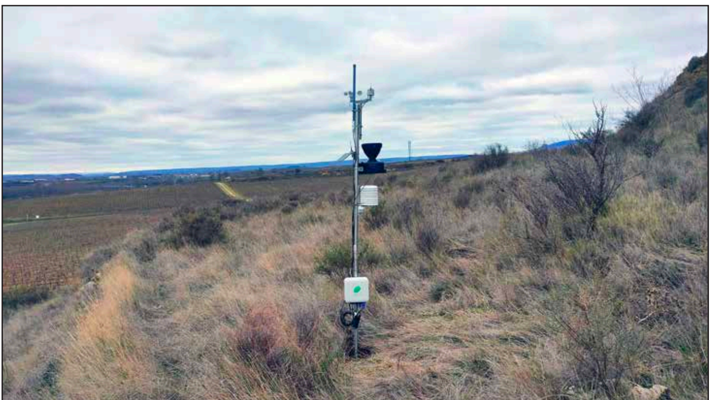
INSTALACIÓN CESENS V2
